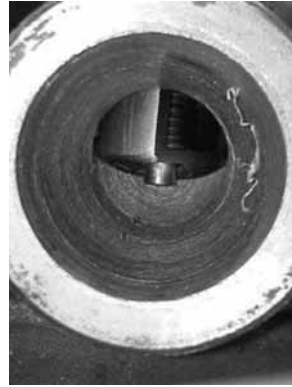
写真5 事故品元弁の状態（戻っていない）
