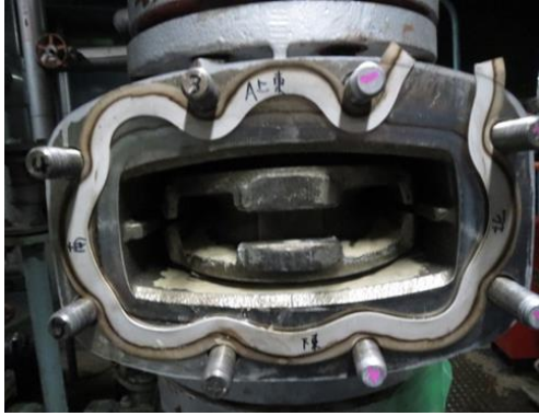
FCV-301 前弁ボンネットフランジガスケット
