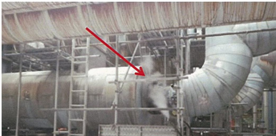
熱交換器全体
