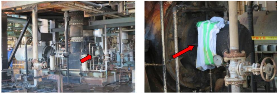
図1 事故発生後のパラキシレン製造装置のポンプ付近 (矢印は、漏えい箇所を示す)
