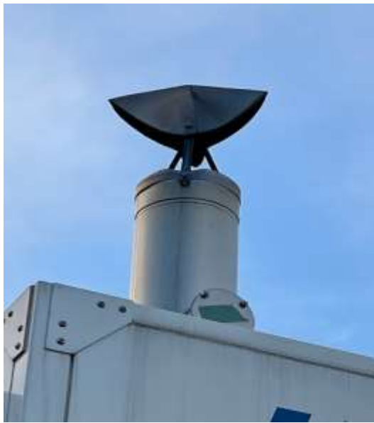
図 2 事故発生直後変形した煙突
