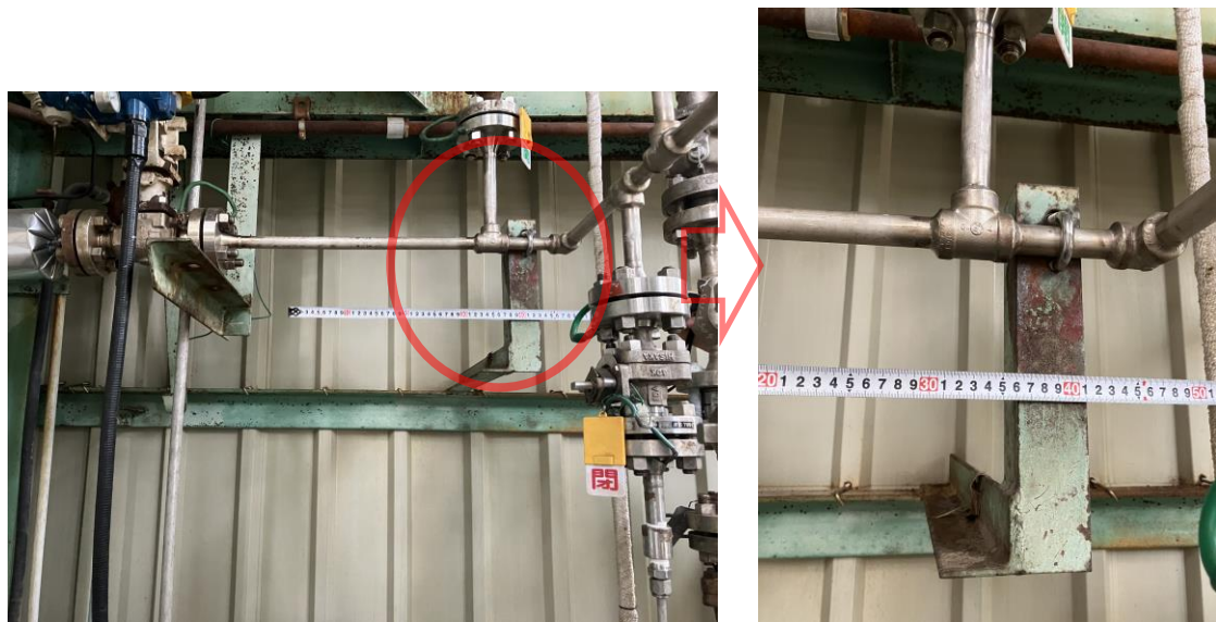
図3 漏えい箇所の詳細(復旧後)
