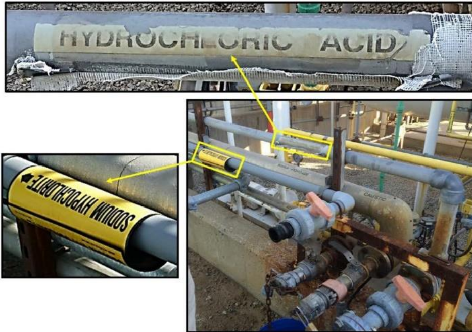
図12：上下逆に表示されている次亜塩素酸ナトリウムの配管マーカ（左）と、以前使用されていた「塩酸」のラベルが残って誤表示されている硫酸の配管（上）。両方の配管マーカは、充填ラインおよびエルボーから数フィートの位置に配置されている（右）（出典：CSB）
