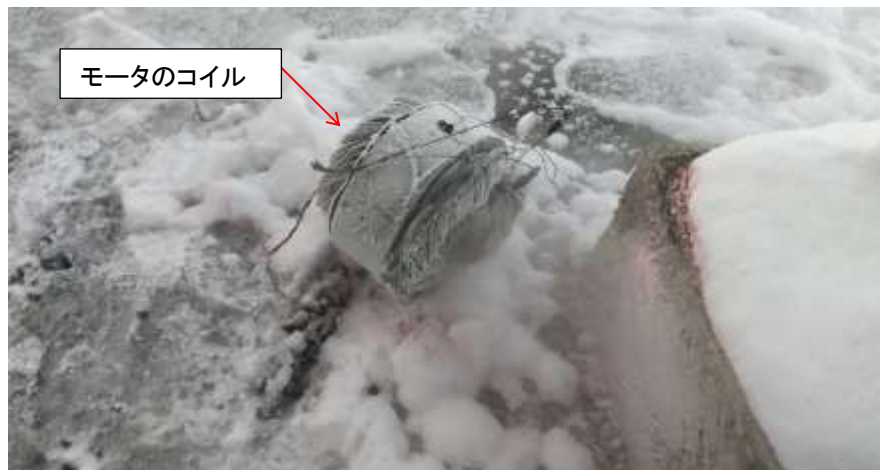
図 2 発災した液化酸素ポンプのモータのコイル部分
