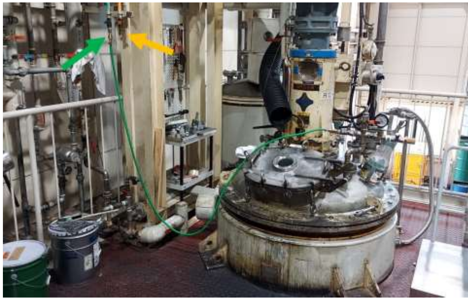
図 1 800L 反応槽 (矢印は、窒素供給配管と圧縮空気供給配管)
