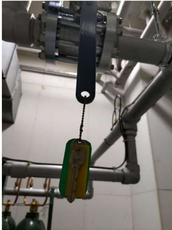
図 7 閉止弁のハンドルに電気室の鍵を取り付けた状況
