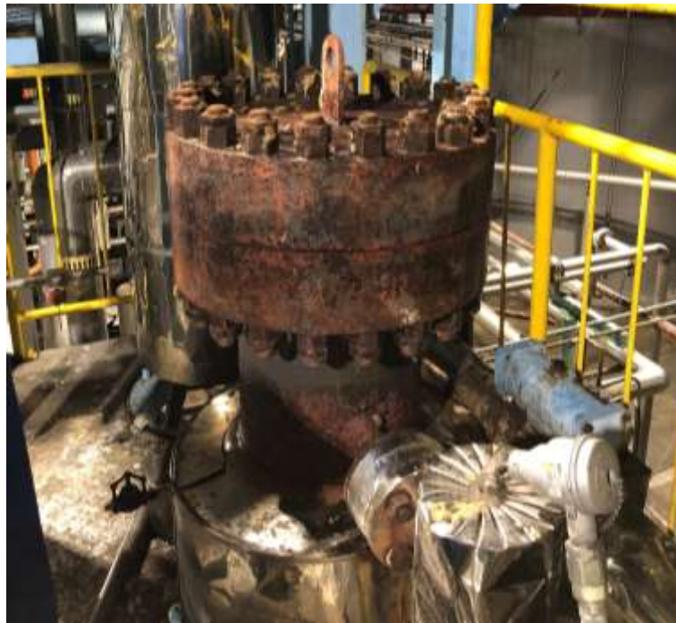
図2 漏えいが発生した脱湿塔 A のボルト締めフランジ継手 (保温外装板と保温材を取り外した状態)
