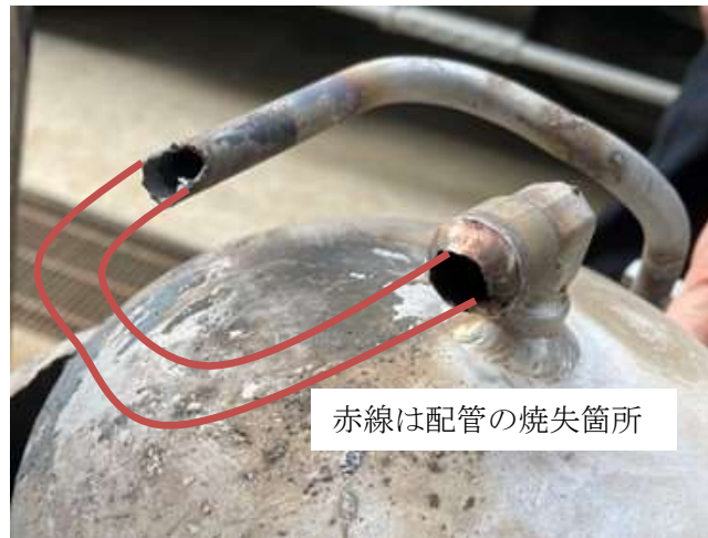
図6 事故後のポンプの状況(内槽の底部)
