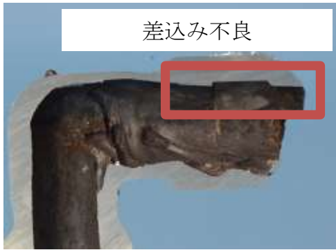
切断後のエルボ(差込み不良)
