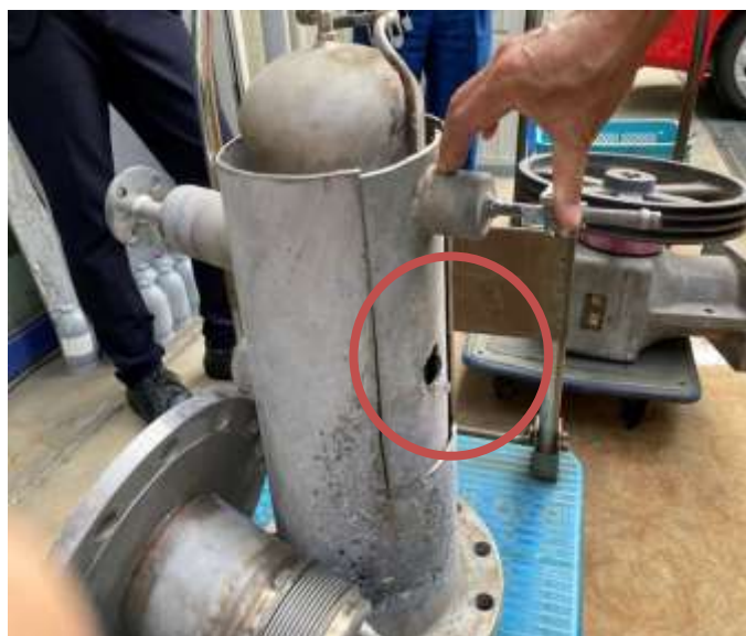
図4 事故後のポンプの状況(外槽)
