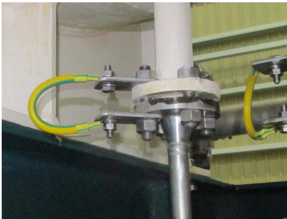
図 3 漏えいが発生した気液分離器のボルト締めフランジ継手
