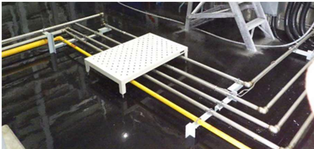
図 4 防液堤内に滞留した電解液
