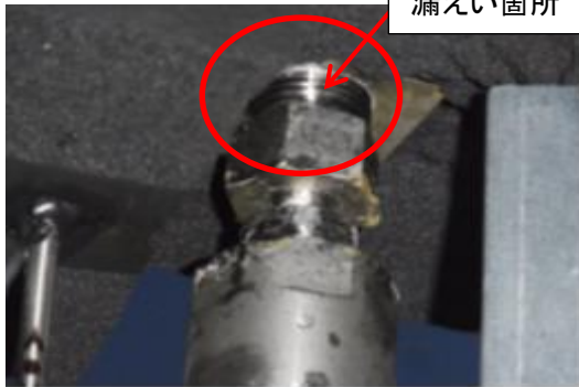
緊急離脱カプラ上部の継手部 (5/23の漏えい箇所)
