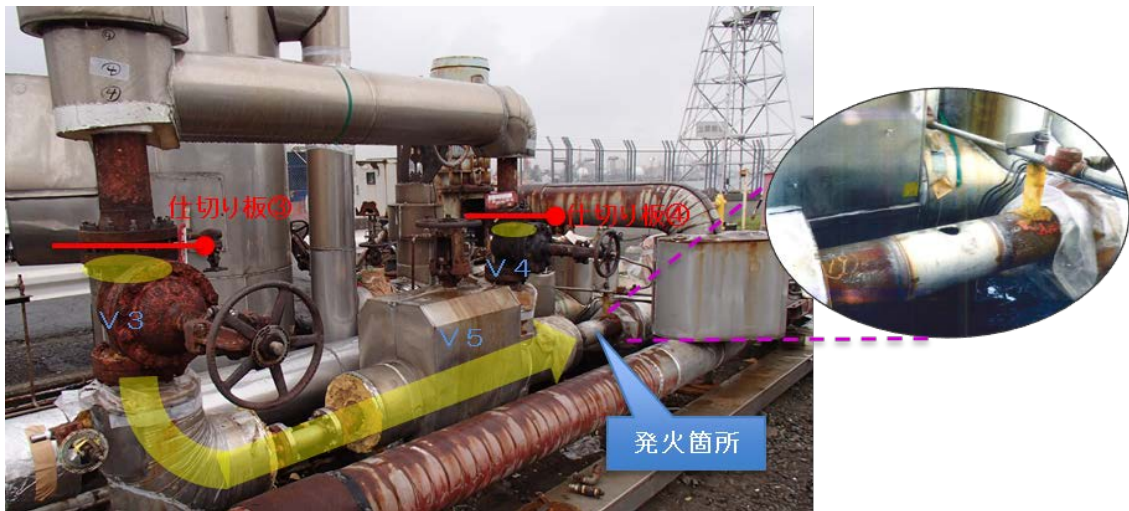
図 1 火災現場の状況
