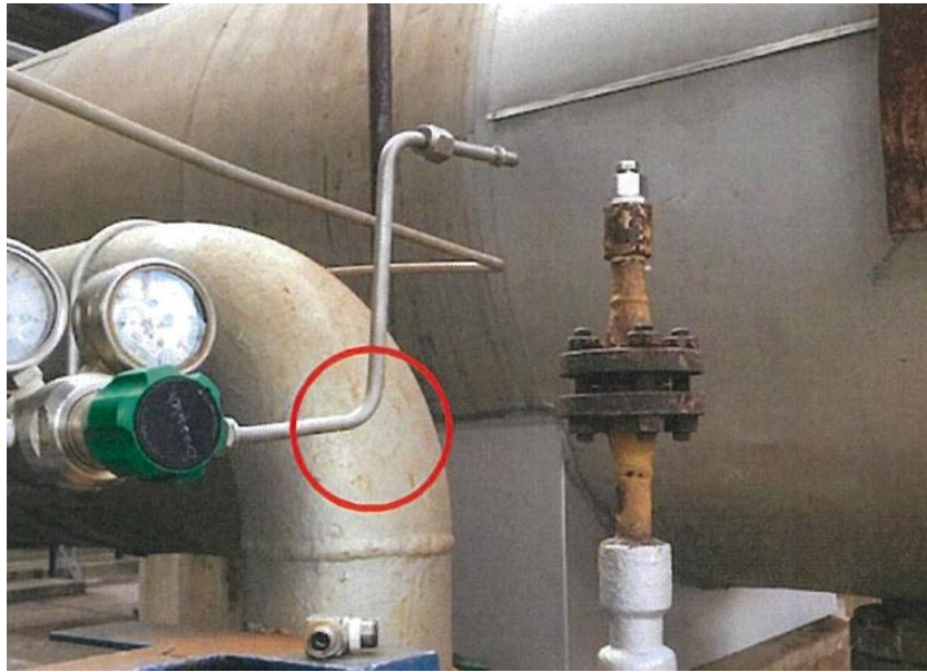
図2 漏えい発生箇所(赤丸部)
