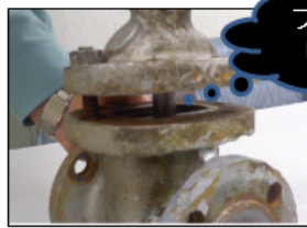
ディスクが閉止したまま ボンネットが浮き上がる
