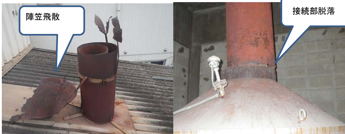
図 3 残ガス処理焼却炉煙突部損傷写真
