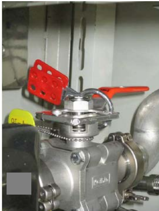
図2 常時開放バルブの固定状況
