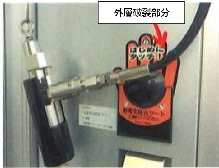
図3 充填ホース外層からの漏えい(事故直後)
