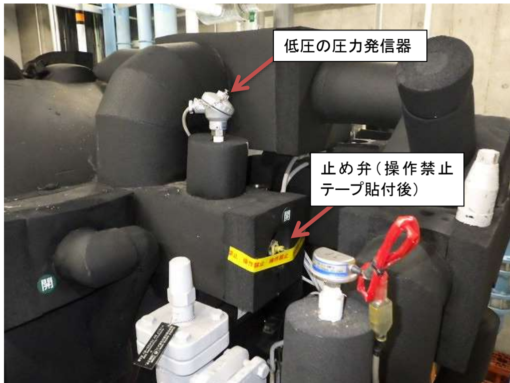
写真 4 低圧の圧力発信器及び操作禁止テープ貼付後の止め弁
