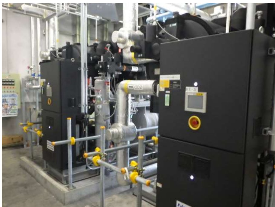
写真1 機械室内の冷凍設備設置状況
