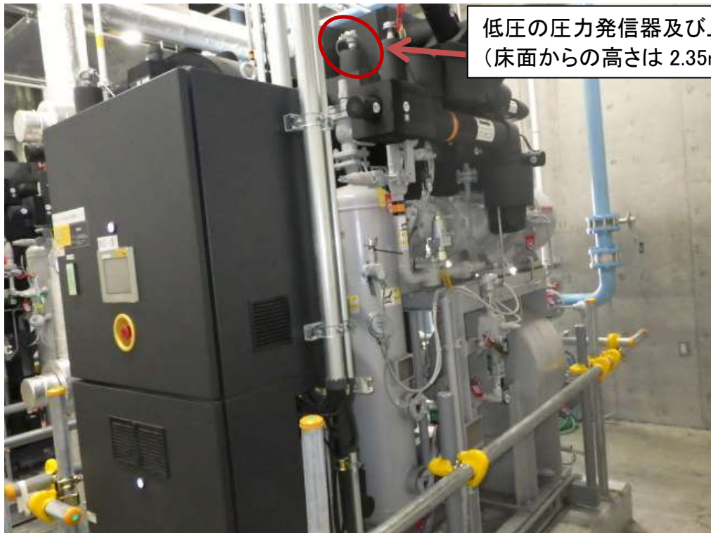
写真 2 冷凍設備の全体写真
