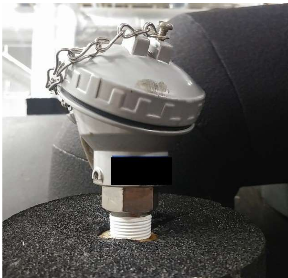
写真 5 低圧の圧力発信器取付け部
