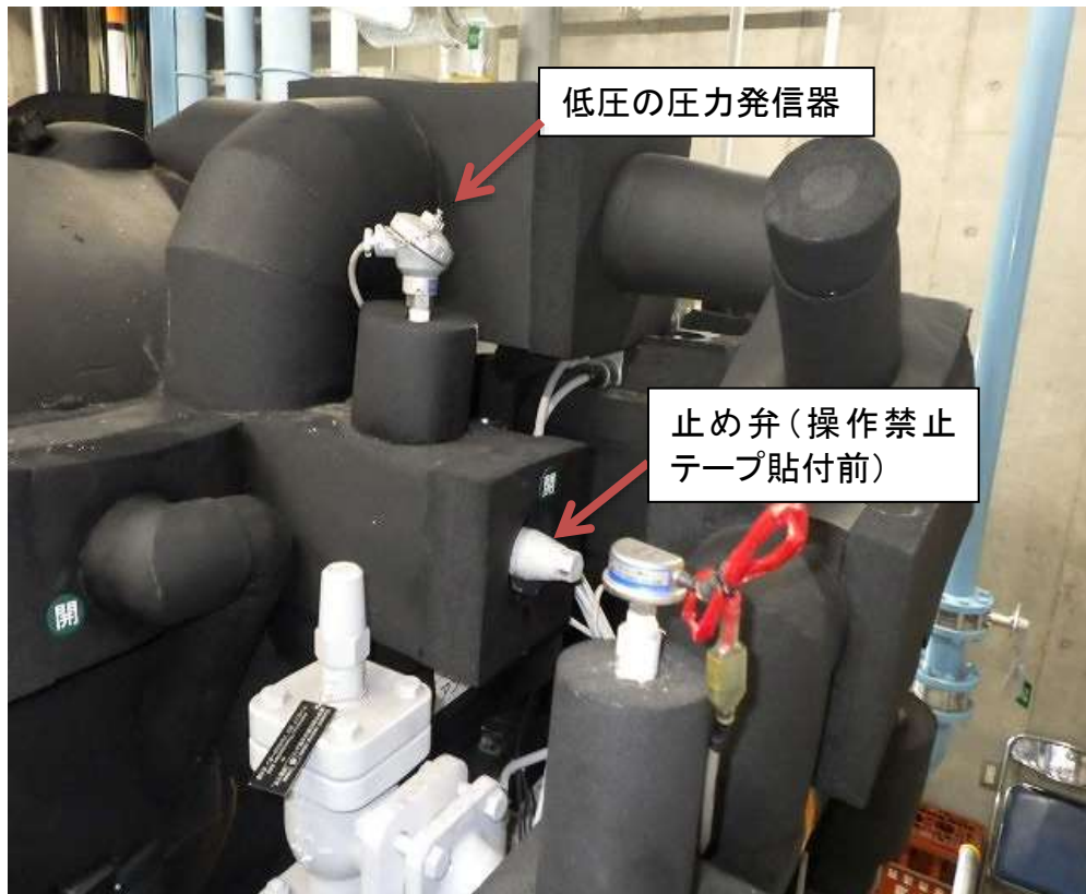
写真 3 低圧の圧力発信器及び操作禁止テープ貼付前の止め弁
