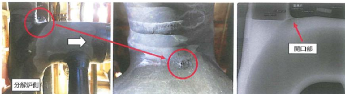
図2 不具合箇所の外観目視及び放射線透過検査
