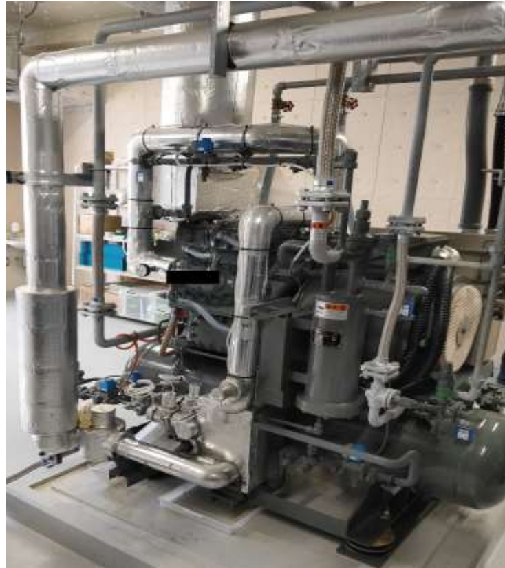
図1 冷凍設備の全体写真
