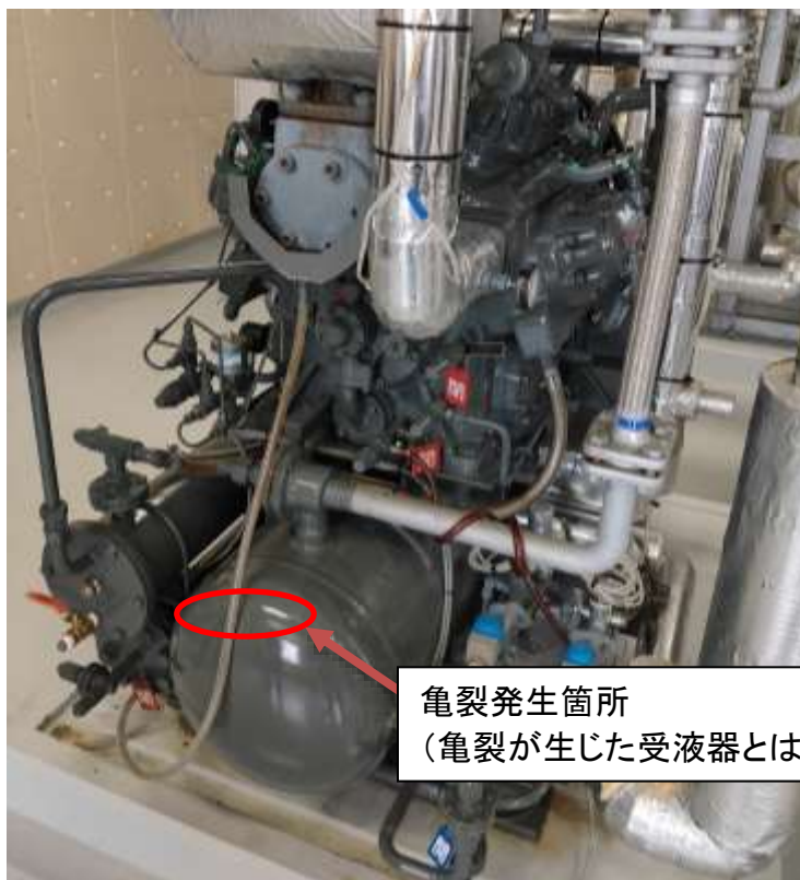
図2 冷凍設備内の受液器
