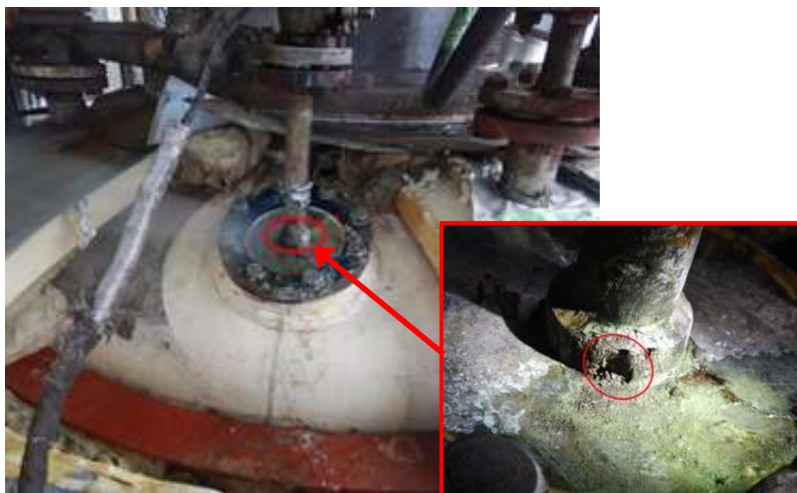
図1 反応槽における漏えい発生部位
