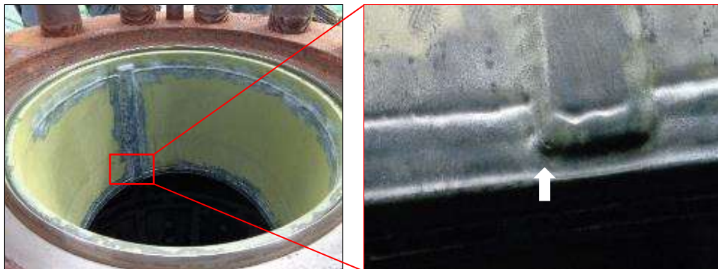
図2 尿素合成塔における漏えい発生部位(右写真 矢印:貫通部分)
