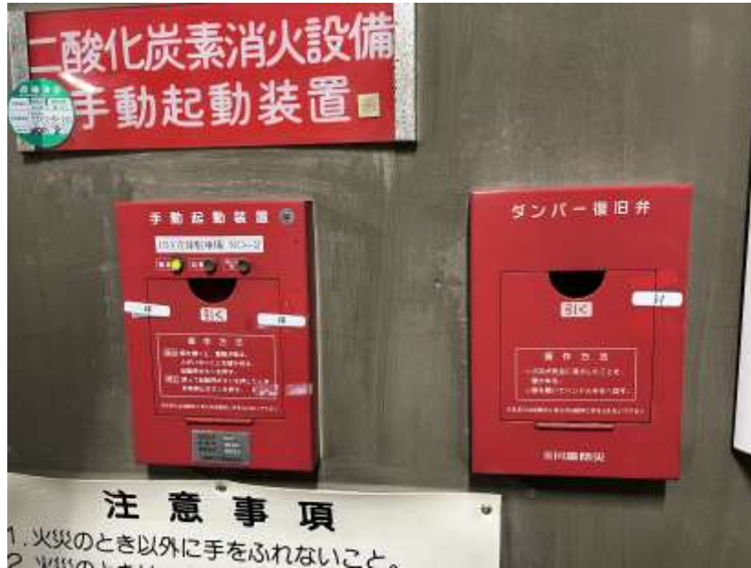
図3 二酸化炭素消火設備の手動起動装置
