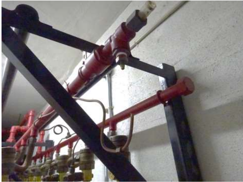
図7 二酸化炭素が放出したとみられる圧力伝達配管(銅管)接続部
