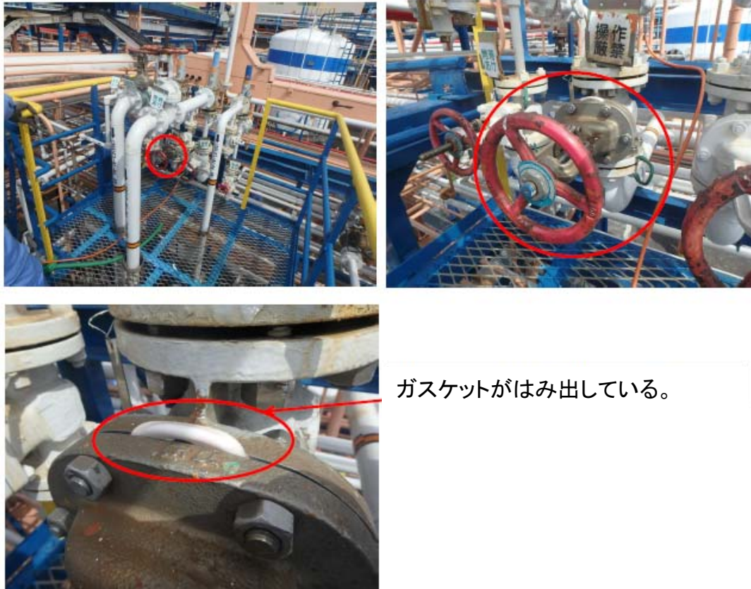
図2 漏洩が発生した仕切弁
