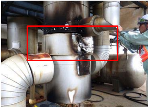
図1 事故直後の漏洩箇所状況
