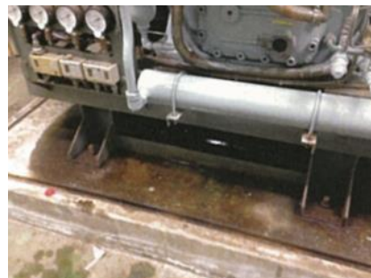
冷媒の漏えい状況
