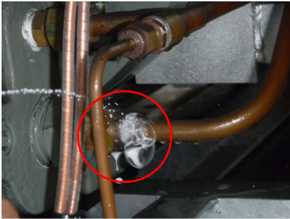
図3 発泡液法による冷媒漏えい箇所の特定
