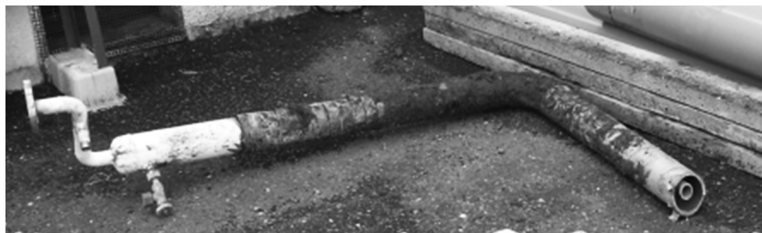
写真1 取り出した地中埋設管の一部 ステンレス管には異常が認められなかったが、鉄管は腐食が進んでいた。
