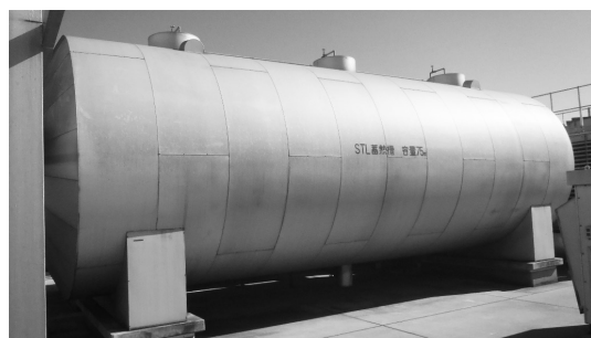
写真2 STL蓄熱タンク設備
