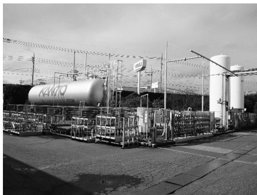
写真5 LPGタンク、C/Eタンク
