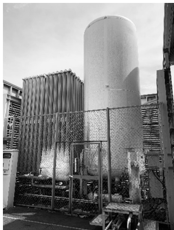
写真2 高圧ガス施設
