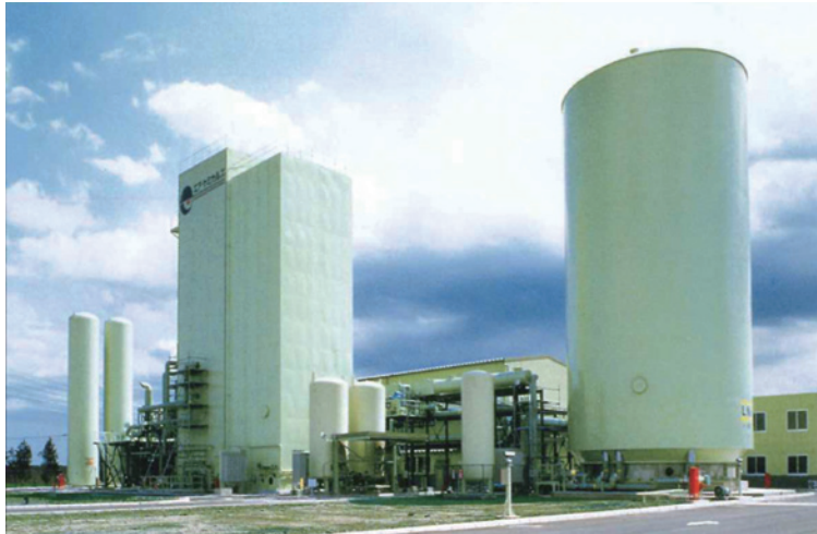
写真2 プラント外観
