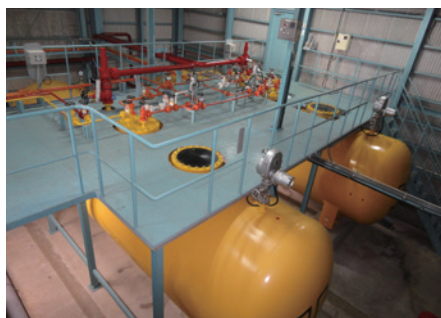
写真2 高圧ガス設備
