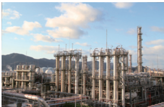
写真1 高圧ガス設備
