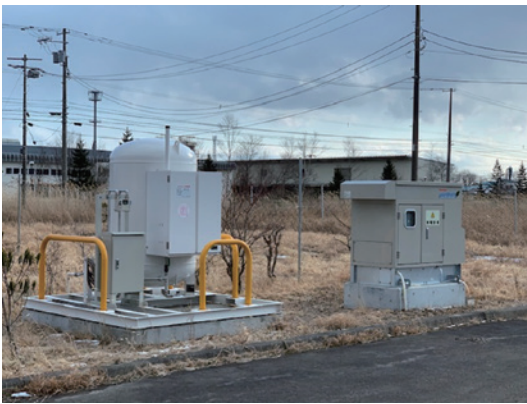
写真1 事務所敷地内 災害用バルクと発電機
