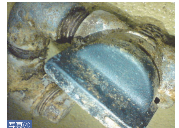
写真④ めんゆで器に接続されていた末端ガス栓の汚れ。(だし汁等がかかった形跡がある。)
