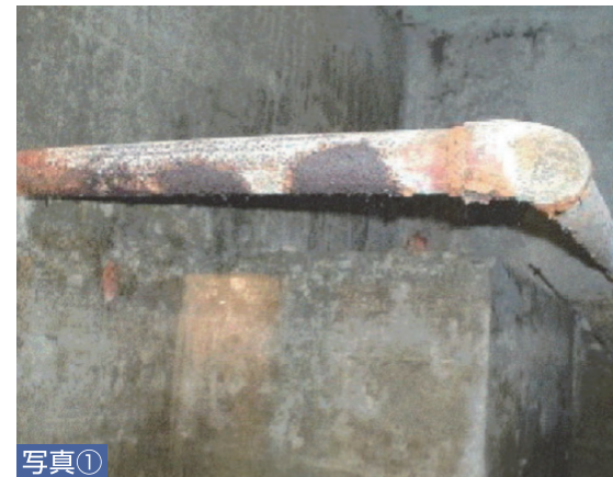
写真① ピット内に設置された配管の腐食。
