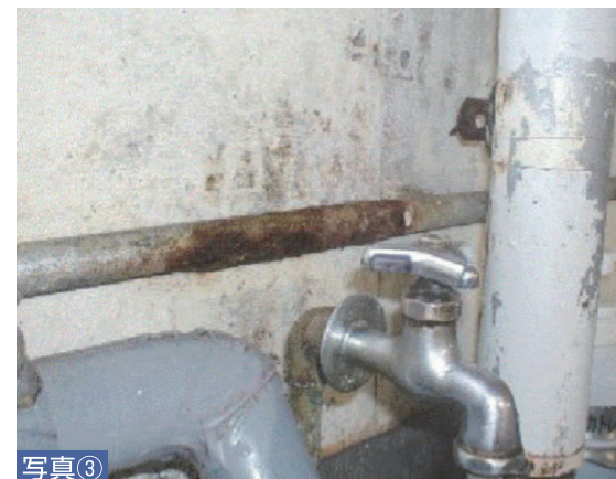
写真③ 水しぶきの掛かる蛇口付近に設置された配管の腐食。
