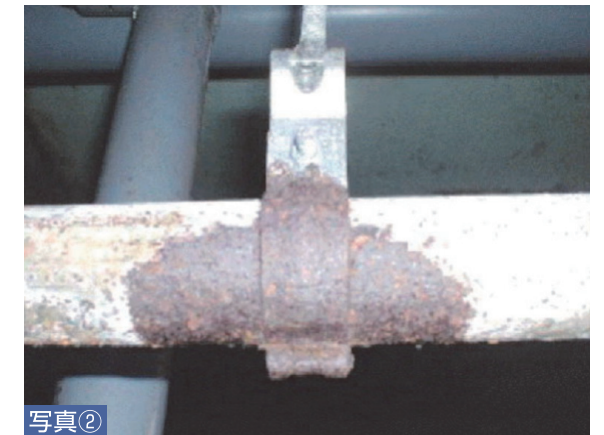
写真② ピット内で異種金属同士が触れ合う箇所の腐食。
