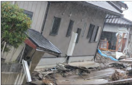
濁流により土台の傾いた住宅
