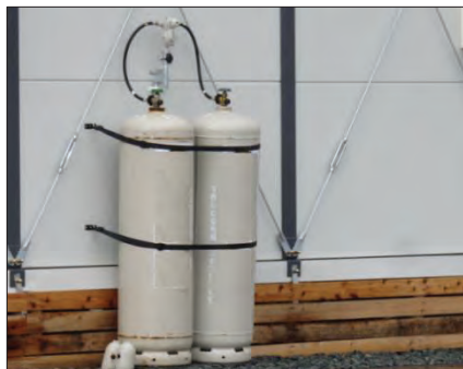
仮設住宅への LPG 供給
