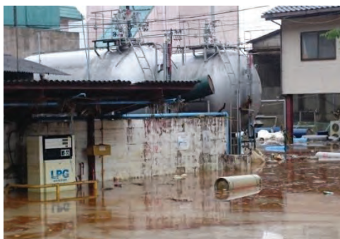
河川の氾濫により水没した充てん所
