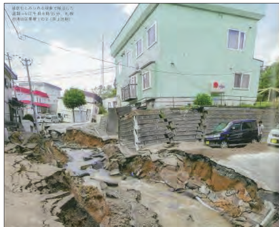
液状化により地盤沈下が発生
