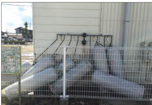
濁流により流出寸前の容器
