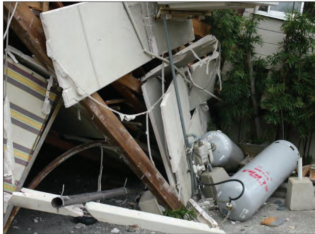
地震で倒壊し家屋で被害のあった LP ガス供給設備【プロパン・ブタンニュース提供】
