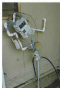
LPガス設備の損傷
