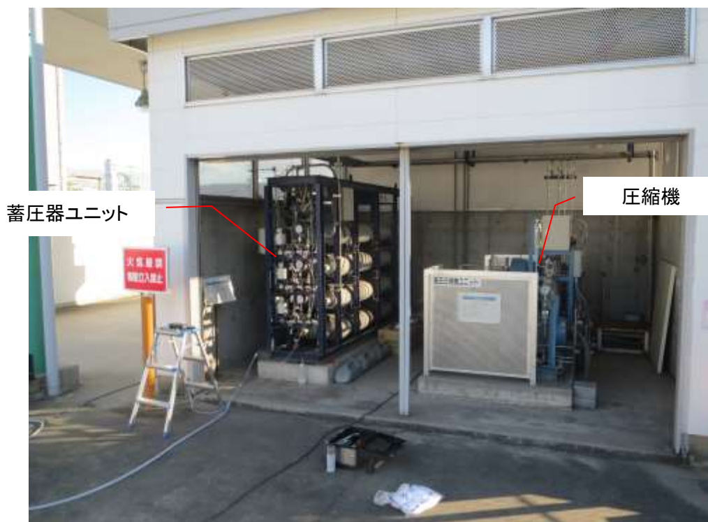
写真1 圧縮機及び蓄圧器の設置状況
