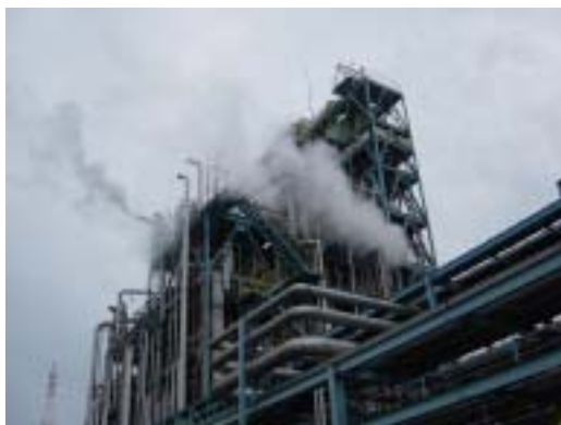
図1：プラント全景
