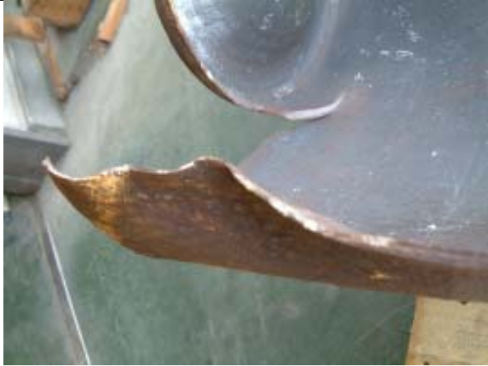
容器下部の腐食状況 (最小肉厚 2.4mm)
