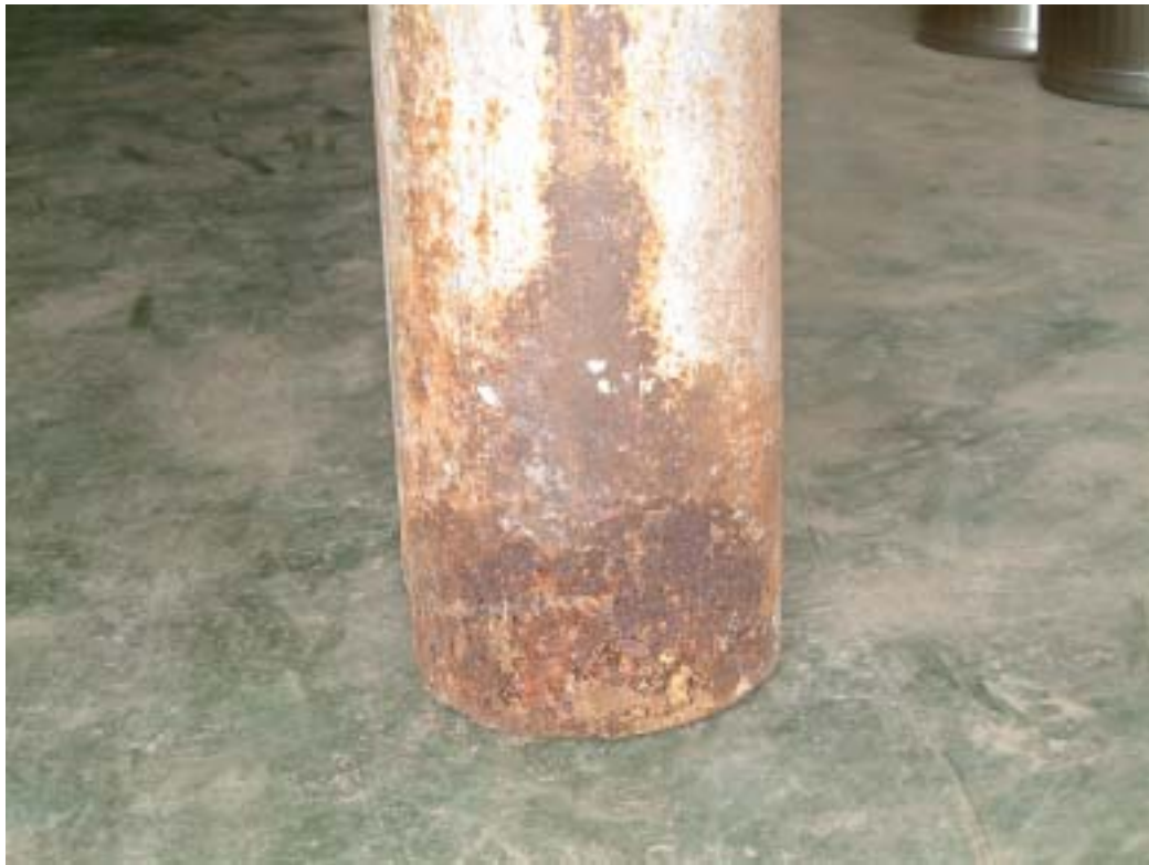
混合ガス容器の外面腐食状況 (最小肉厚 6.7mm)
