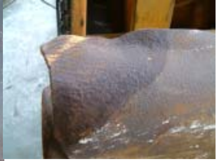
容器下部外面の腐食状況
