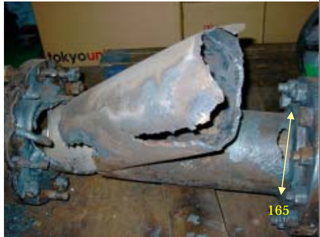
図3 ストレーナの焼損状況
