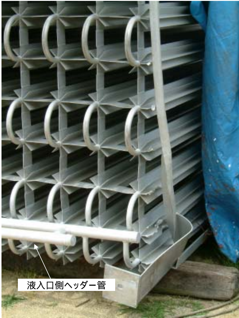
フレームから脱落した状況 (横積み状態を下側から写す)
