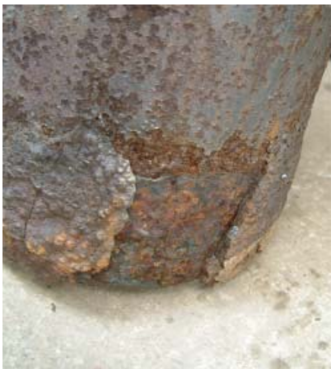
トラックに積載されていた酸素容器の外面腐食の状況
