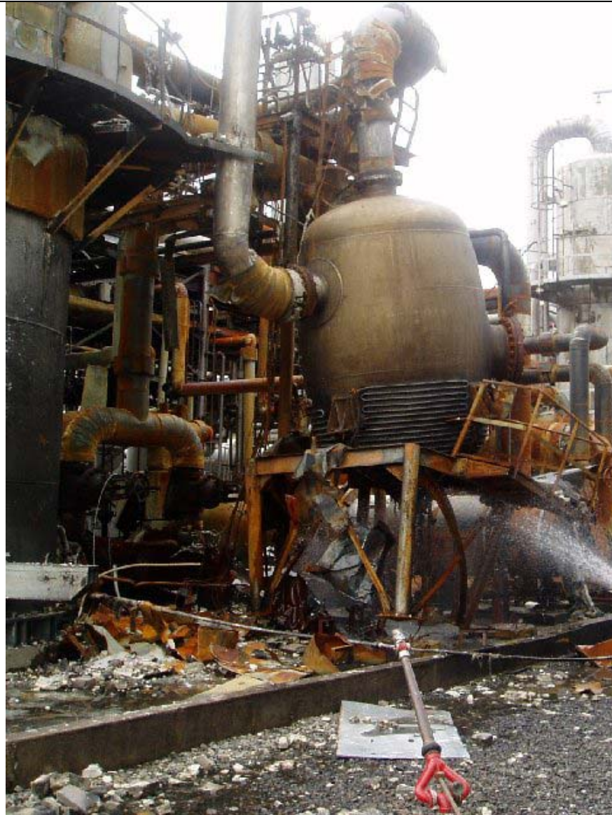
写真1 ミスト分離器の周辺状況
