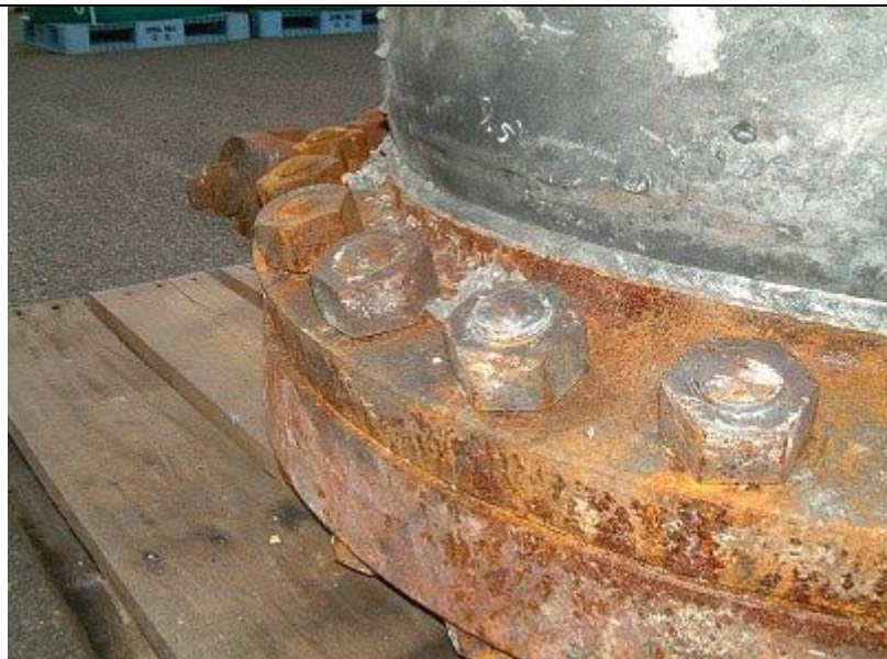
写真3 ミスト分離器のマンホール
