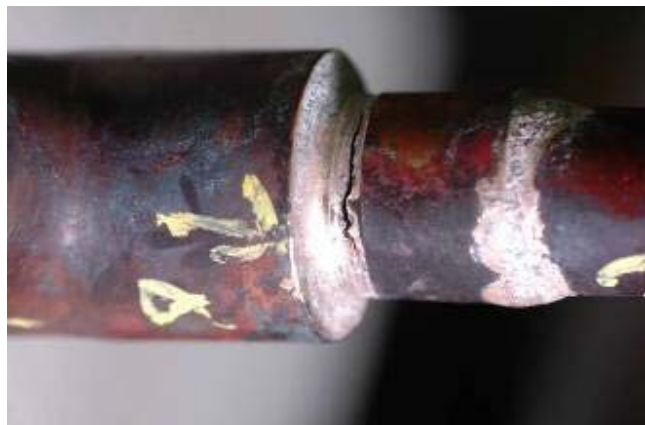
破断した配管 (レデューサ)写真
